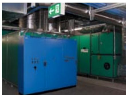
Automation HLK: Eine der vielen Lüftungsanlagen mit dem entsprechenden Schaltschrank für die Automation von Leicom.
