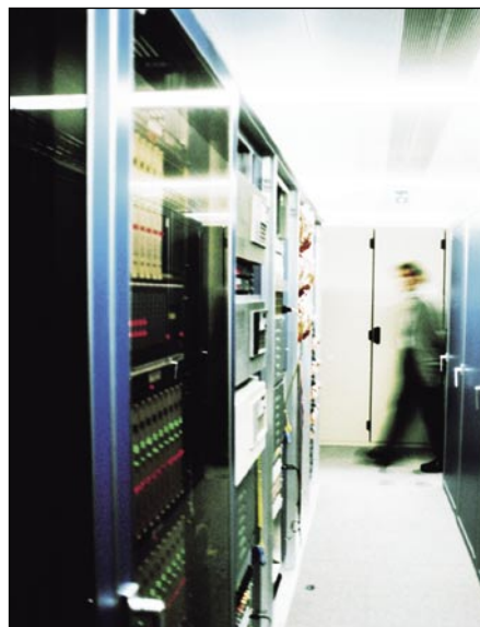
Die neue, redundant aufgebaute Anlage funktioniert zur vollen Zufriedenheit der Betreiber.
